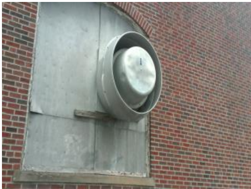
Exhaust Fan Ventilation
